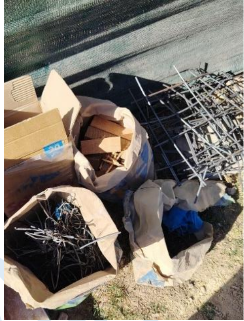
Foto N°2 Acumulación del alambre
